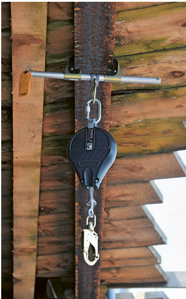
22 An mobilem Anschlagpunkt montiertes Höhensicherungsgerät.
