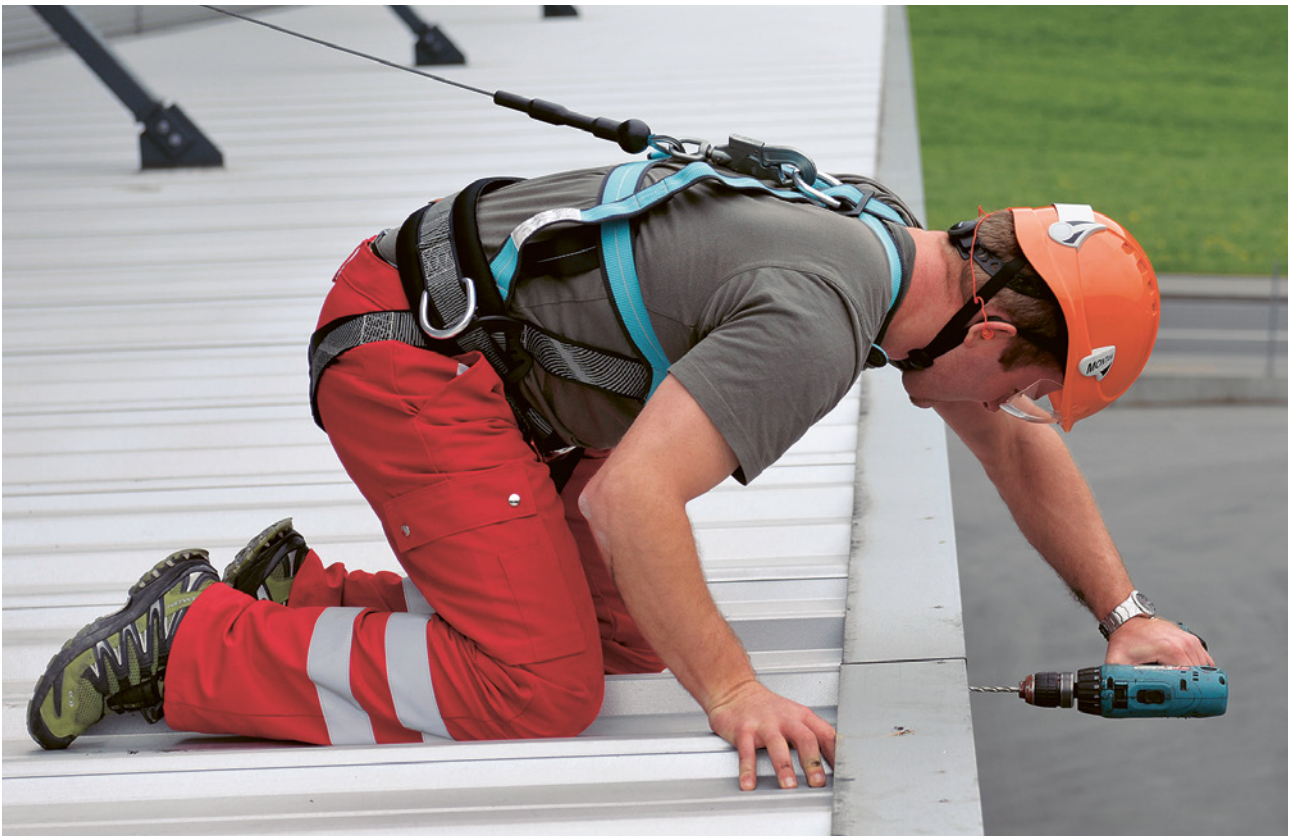
18 Arbeiten an einer Absturzkante.
